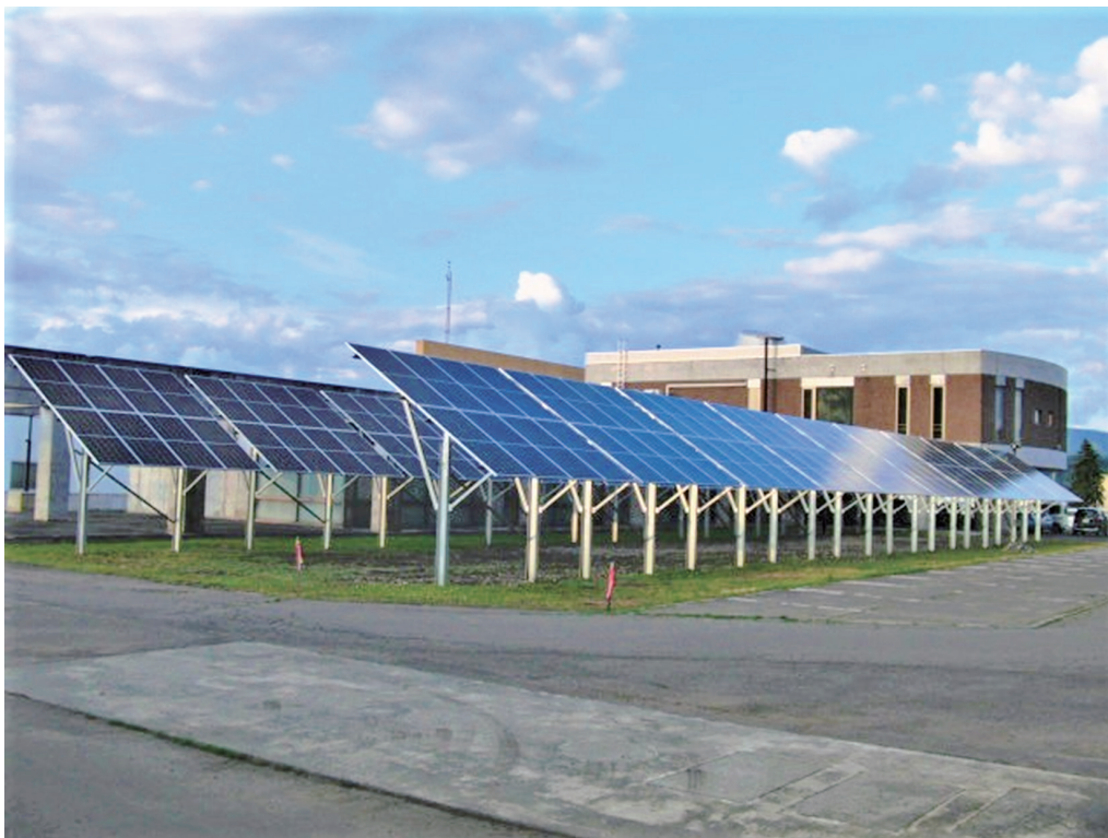
新たに導入された太陽光発電設備
